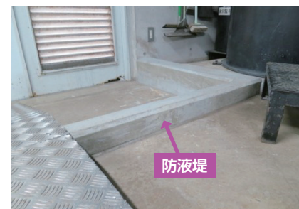
処理室出入り口の防液堤
