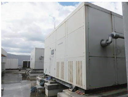
吸収式冷凍機 (ガス)
