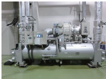
ターボ冷凍機 (電気)
