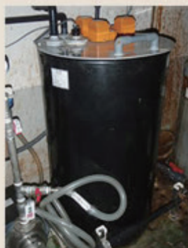
地上にタンク設置
