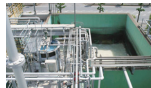
排水処理施設(石岡工場)
