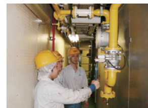
地震発生を想定した乾燥炉停止訓練（横浜）
