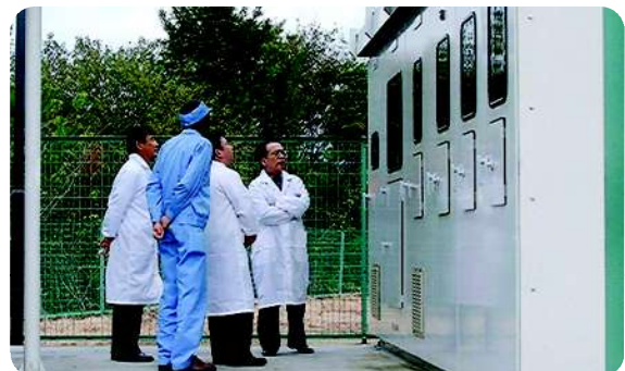
変圧設備の確認
