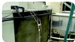
空調機省エネ装置(横浜工場)
